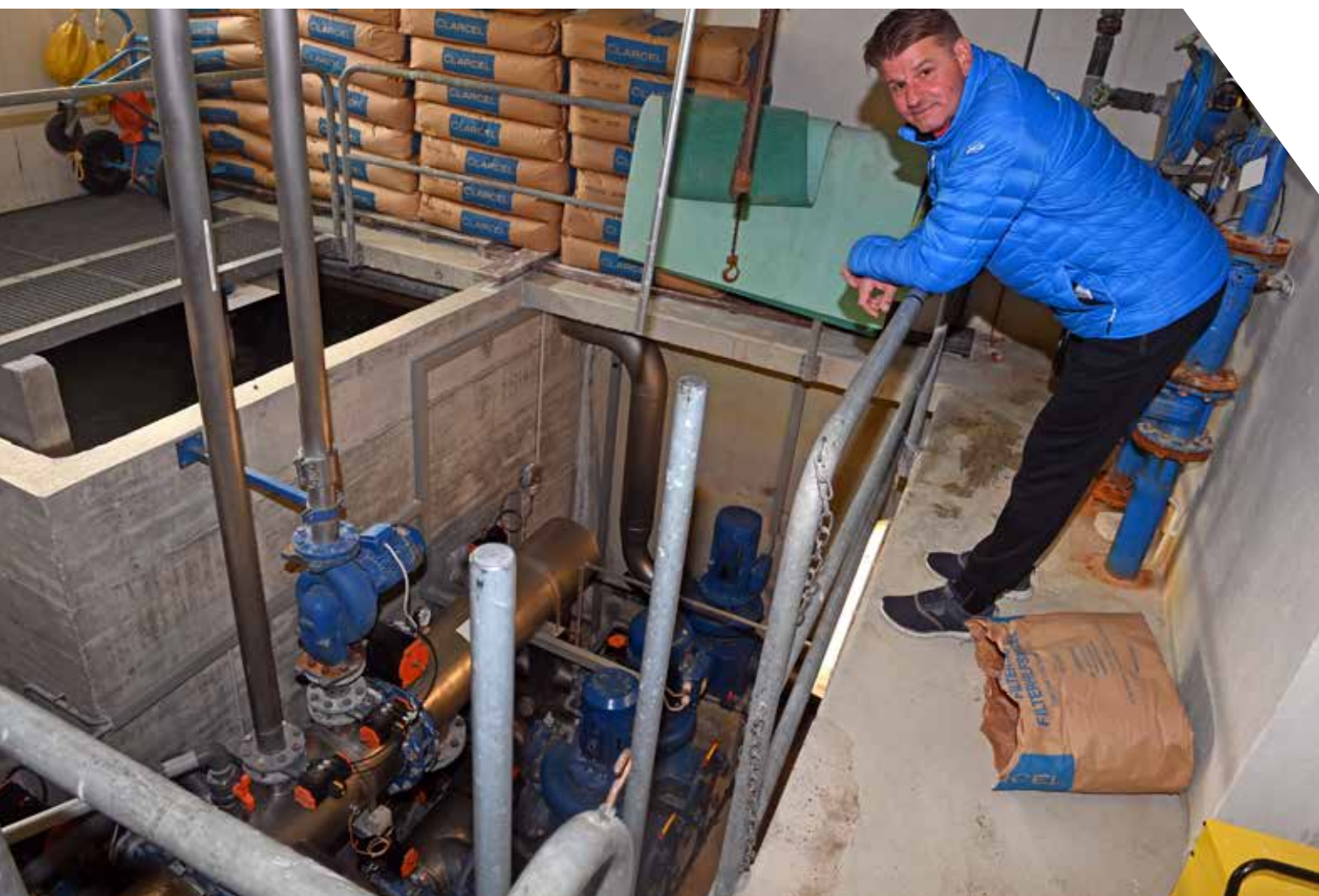
Romain Crevoisier règne sur le local technique où, en plus des pompes, le contenu des sacs permet aux installations de filtrage de fonctionner.
